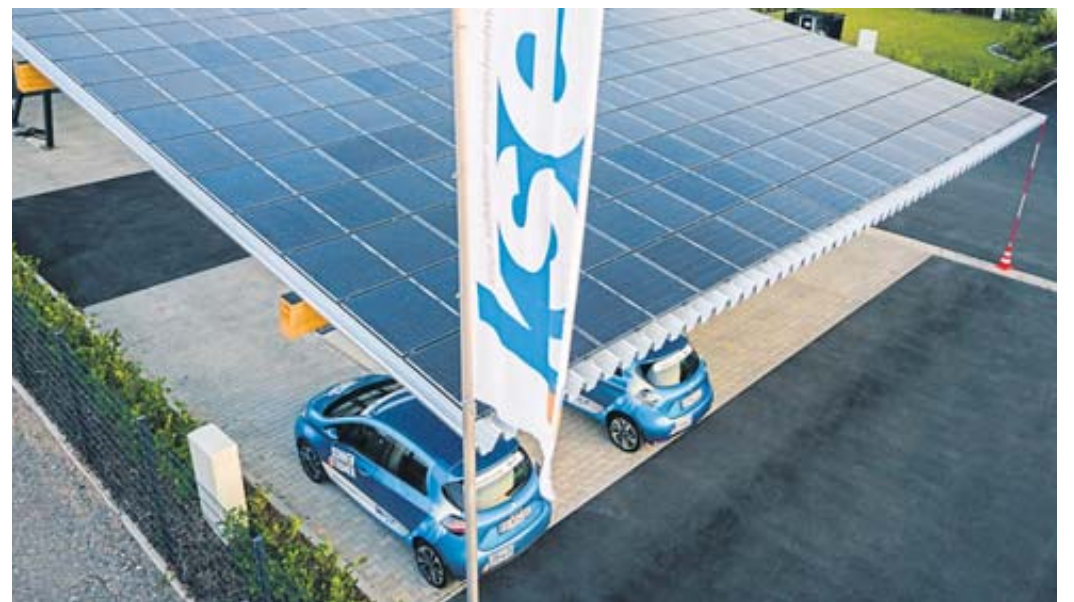
Die „Photovoltaik-Experten in Osthessen“ tanken natürlich an den hauseigenen Hochleistungs-E-Ladesäulen unter einem Carport, das wiederum mit Photovoltaik-Anlagen bestückt ist. Foto: Martin Morgenweck
